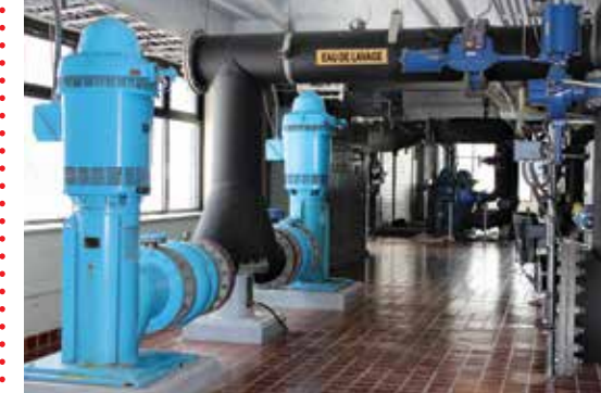
Usine de filtration
